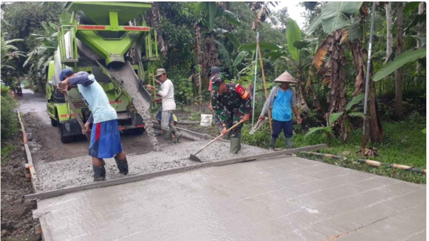
Serda Badri bersama warga masyarakat melaksanakan karya bakti pembangunan rabat beton jalan desa dengan volume 137 x 3 x 0,20 M di Dusun Kedungpandan
