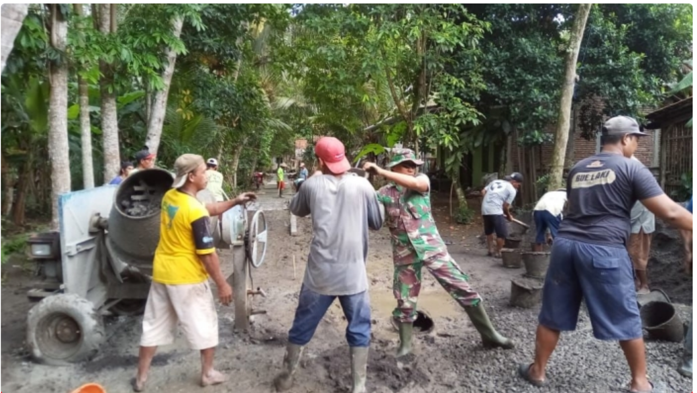
Serda Slamet Supriyono bersama warga masyarakat pada hari kedua melaksanakan kegiatan kerjabakti pengecoran jalan gang / pembangunan rabat beton
